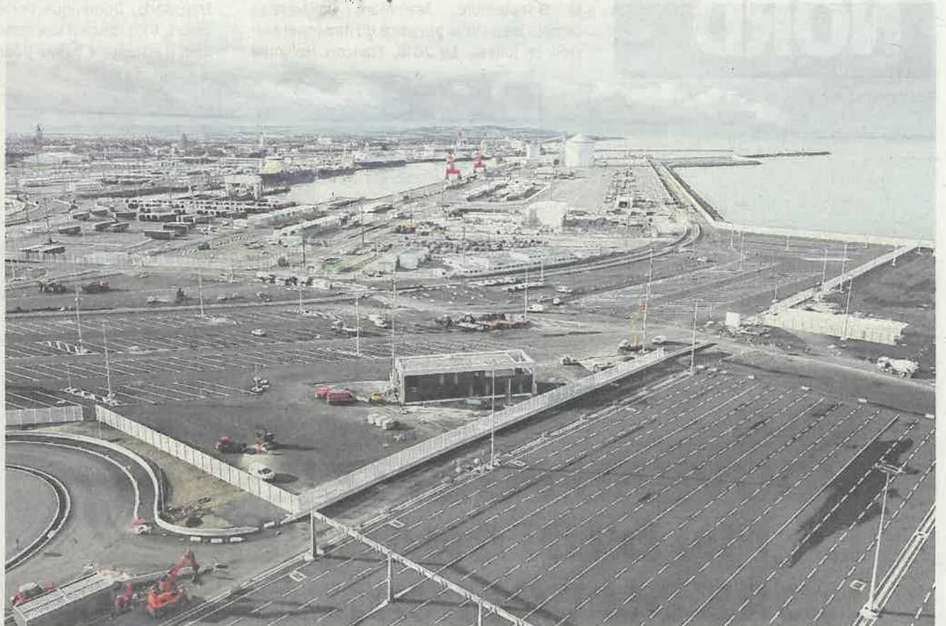
Avec le nouveau bassin, les capacités actuelles seront doublées. PHOTO JOHAN BEN AZZOUC
