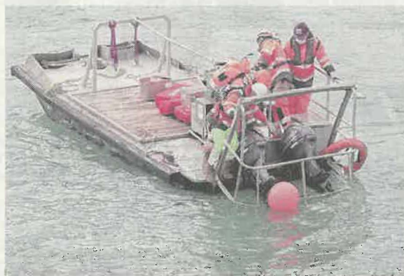
Des équipes de plongeurs vérifient la pose de matelas en béton au fond du bassin. PHOTO JOHAN BEN AZZOUZ
