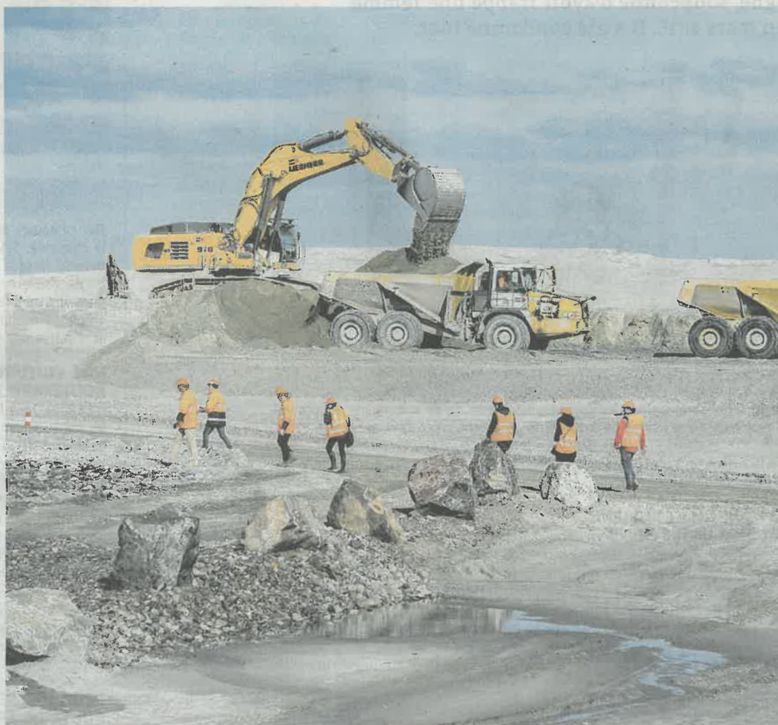
Le chantier d'extension du port, actuellement en cours, ne devrait être touché ni physiquement, ni économiquement, par le recours d'Eurotunnel. PHOTO PASCAL BONNIERE
