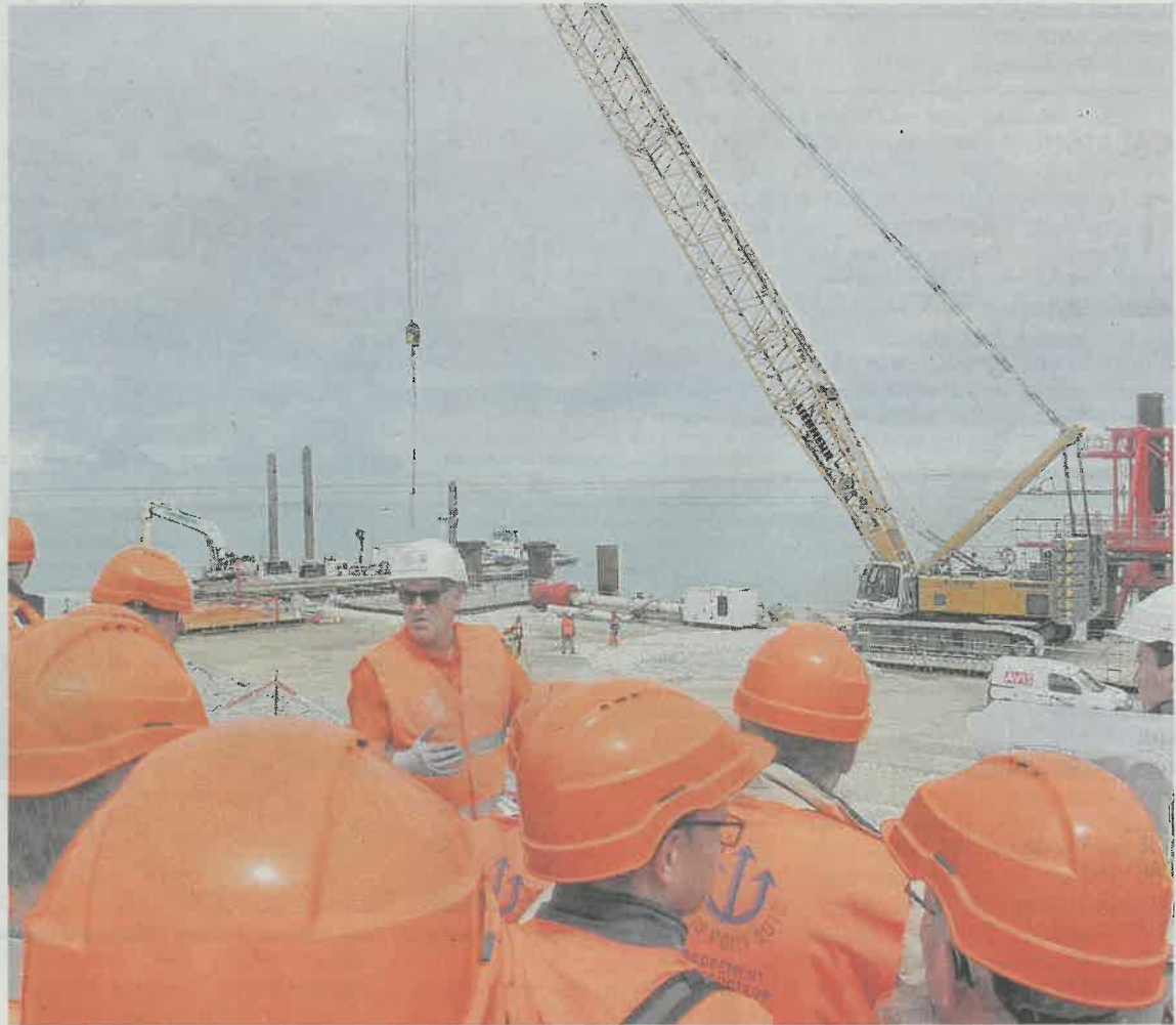
Les visiteurs ont pu découvrir les engins utilisés sur le chantier, visiter l'usine Xblocs et connaître les caractéristiques du chantier.
