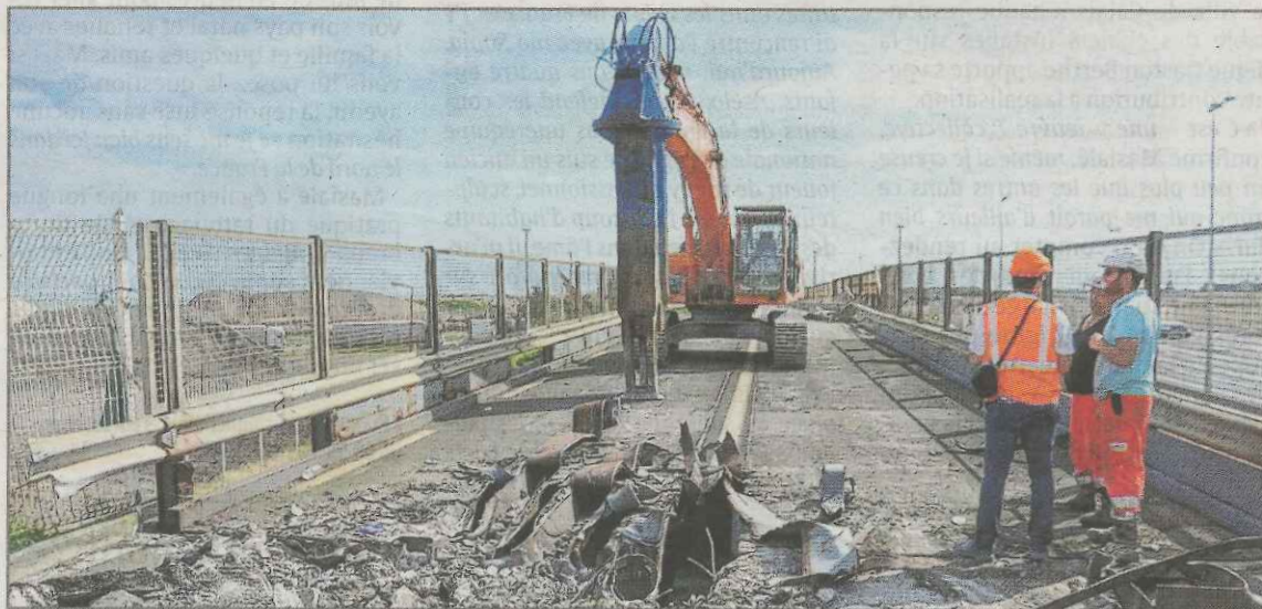
La cisaille a commencé par s'attaquer au tablier du pont, fait de métal. Un travail laborieux qui prend quelques jours aux équipes.
