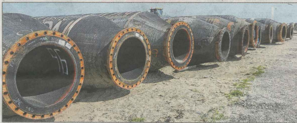
Livrés par camions, les boudins, mis bout à bout, acheminent eau et sable depuis le large, sur 700 mètres.
